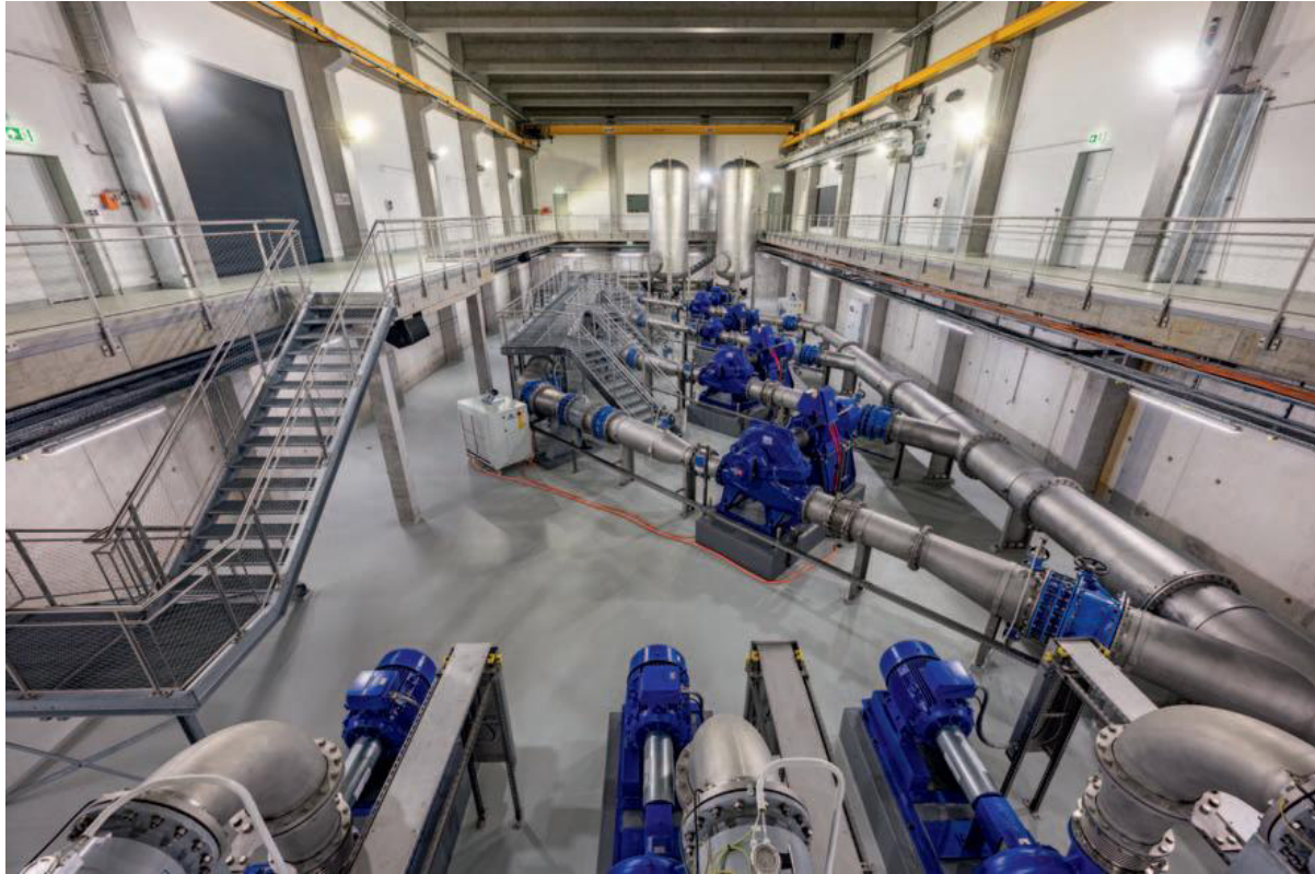
Abb. 6: Blick in die Netzpumpenhalle, im Vordergrund die drei Rückspülpumpen der Aufbereitungsfilter, im hinteren Bild die Netzpumpen und Druckstoßkessel
