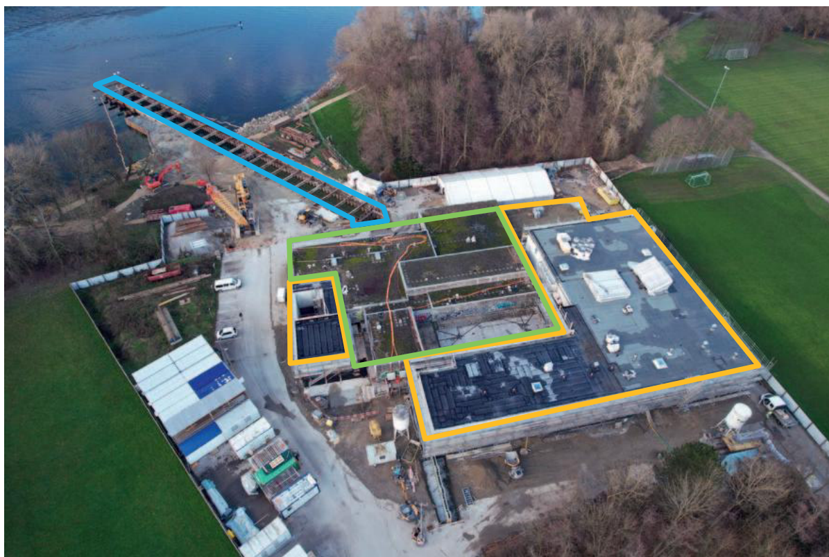
Abb. 5: Baustelle des neuen Seewasserwerks am 20.12.2022. In grün ist das bestehende Werk markiert. In gelb die Bauphase 1. Ein Teil des bestehenden Werkes musste in der Bauphase 1 bereits stillgelegt werden, damit dort die Schwemmwasseraufbereitung des neuen Werks realisiert werden konnte. Der oberirdische Teil des bestehenden Werkes wird in der Bauphase 2 rückgebaut und die zweite Hälfte des neuen Werks an dieser Stelle errichtet. Blau markiert ist der Korridor der zwei neuen 750 m langen Rohwasserleitungen.
